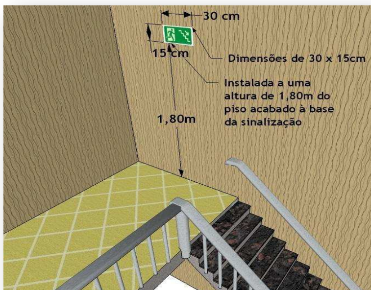
Figura 39 - Sinalização de escada de emergência
