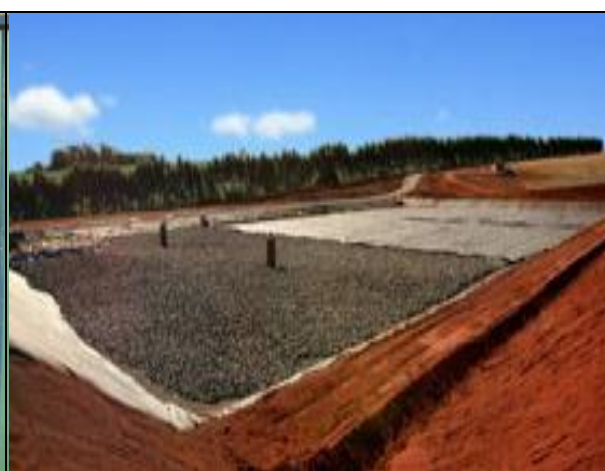
FOTO 06 – Tratamento de Efluente
